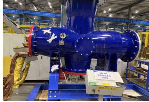
图 6 GIS 三工位开关温升测试装置 Fig. 6 GIS three-position switch temperature rise test device
